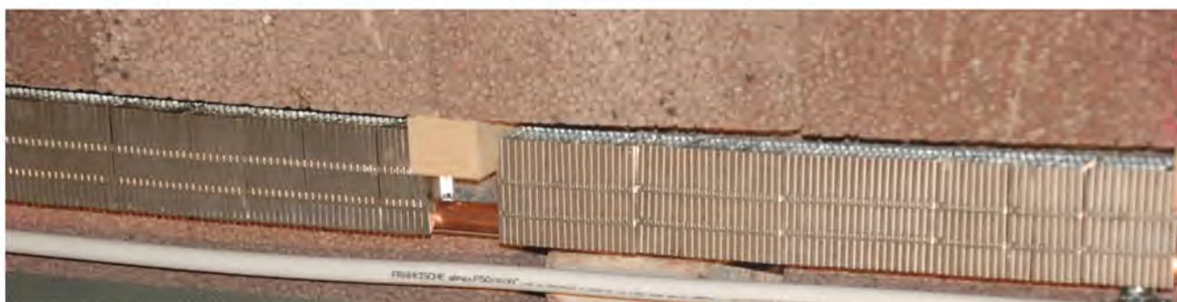
Abb.8 Heizregister verstärken die Heizleistung – Mit Brennwerttechnik oder Pellet-Heizungen lassen sich die besten Ergebnisse erzielen.
